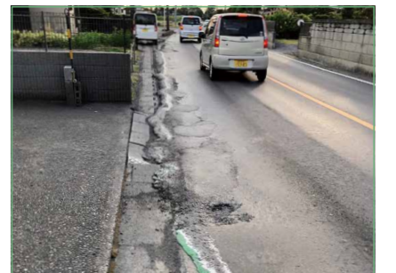
補修を繰り返している既存の県道
